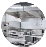
中央厨房设备
